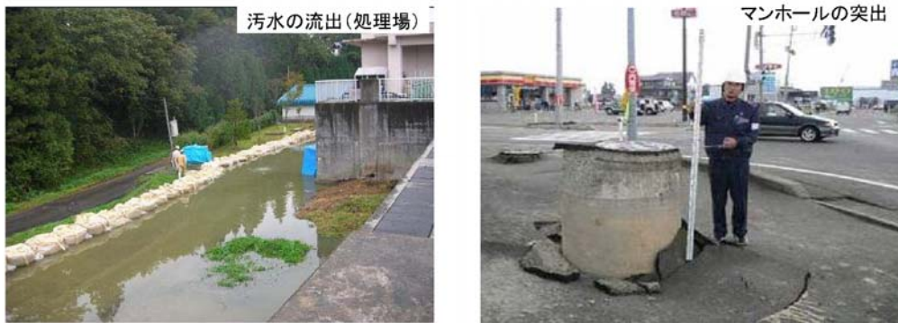
図 3-2-27. 新潟県中越地震における下水道施設の被害の状況
