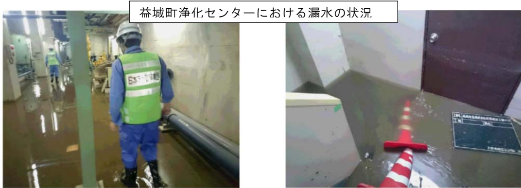
図 3-2-29. 熊本地震における下水道施設の被害の状況
